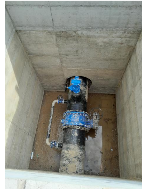
Organi di intercettazione sulla condotta
