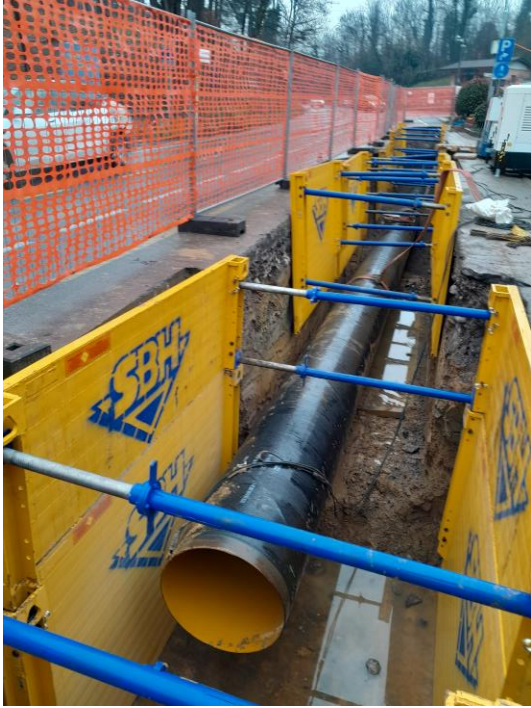
Posa tubazione in scavo armato lungo la ex SS470 in Comune di Almè
