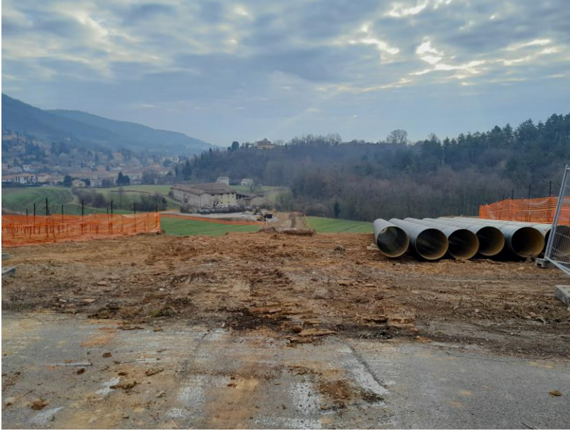
Tubazioni nella zona di Valmarina a Bergamo
